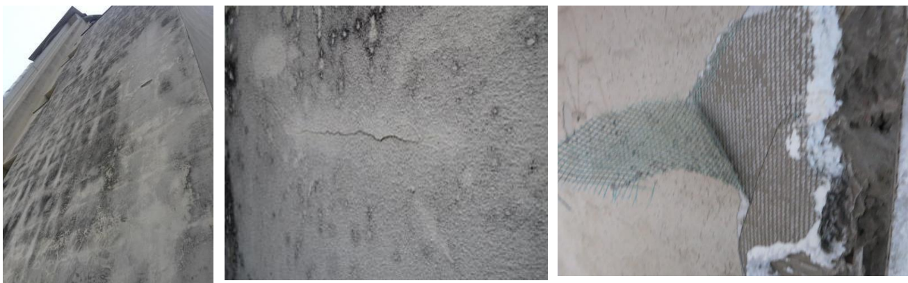
Distacco rasatura armata da pannello isolante
