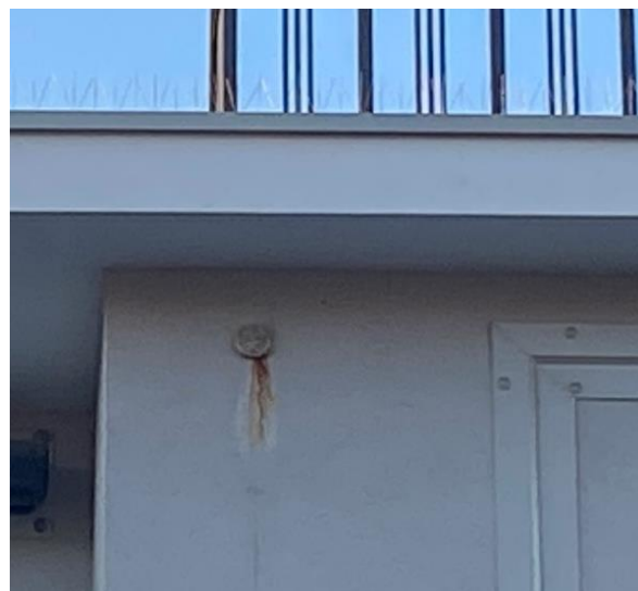
Mancato posizionamento dei nastri di guarnizione
