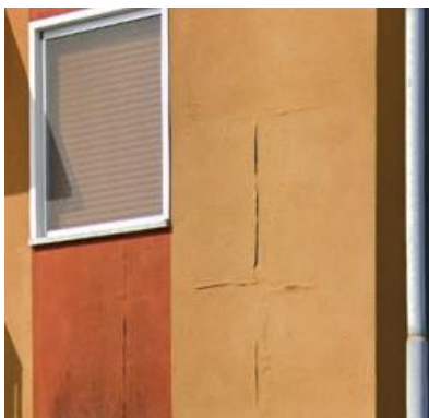
Distacco parziale rivestimento di finitura da rasatura armata
