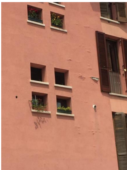
Distacco totale rivestimento di finitura da rasatura armata
