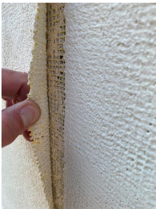
Rete mal posizionata e rasante in spessore insufficiente
