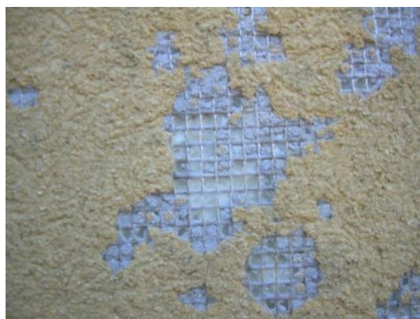
Rete mal posizionata
