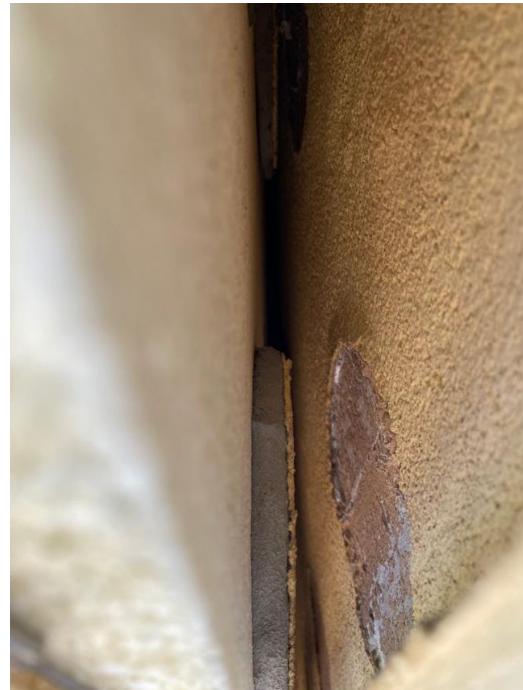
Distacco del vecchio rivestimento di finitura
