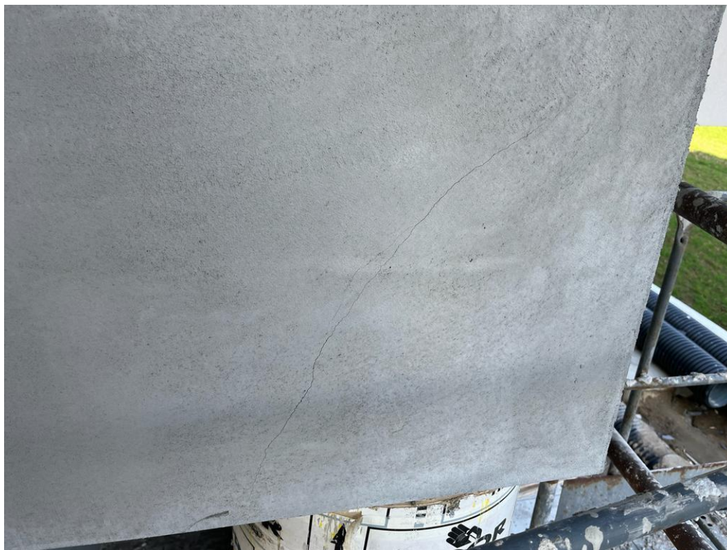
Eccessivo spessore di rasante cementizio
