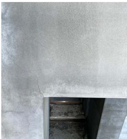
Mancato o errato posizionamento dei fazzoletti di rete
