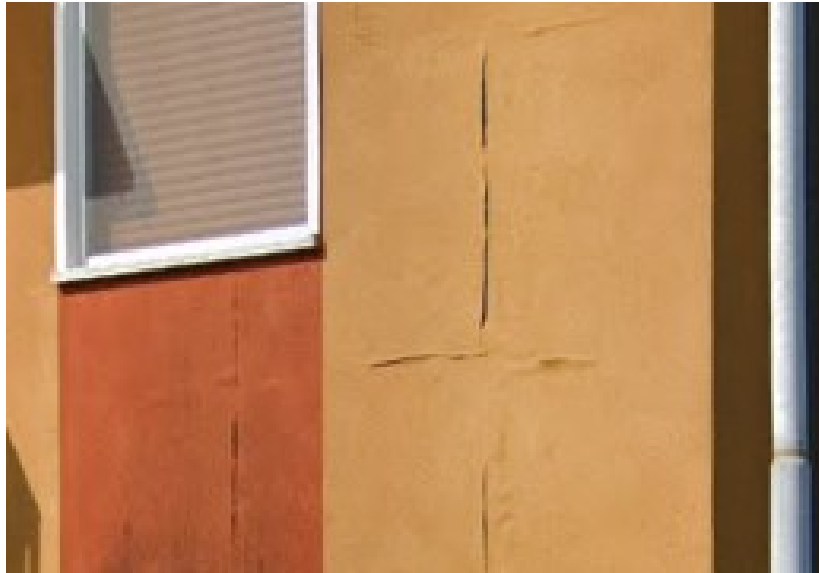
Distacco parziale rivestimento di finitura da rasatura armata
