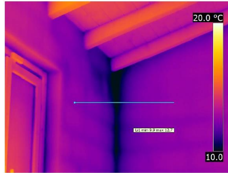
Assenza di isolamento termico: ponte termico e temperature superficiali ridotte
