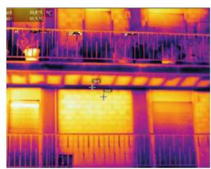
Facciata di edificio, \Delta T = 3,3 \text{ }^\circ\text{C} giugno, esposizione sud, ora di pranzo
