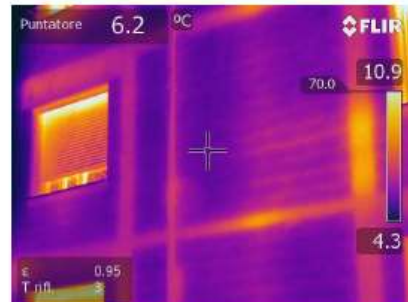
Presenza di tamponamenti in mattoni e cassonetti serramenti. Assenza sottofinestra
