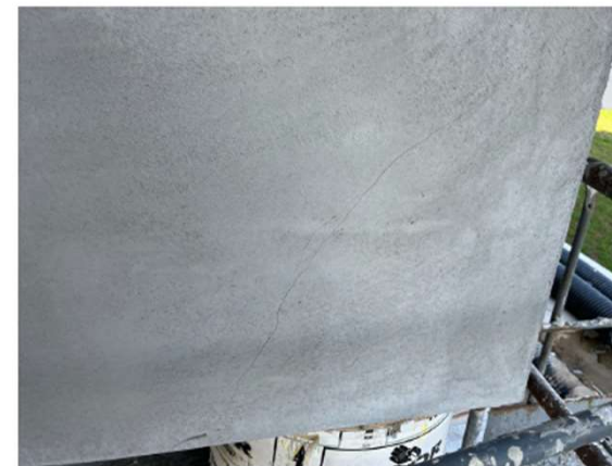
Eccessivo spessore di rasante cementizio
