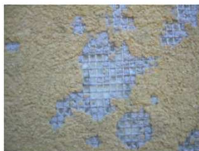
Rete mal posizionata
