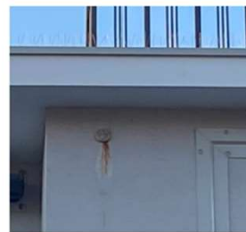
Mancato posizionamento dei nastri di guarnizione
