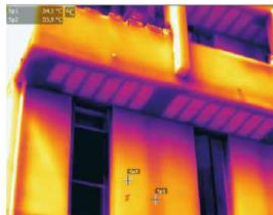
Facciata di edificio, \Delta T = 1.6 \text{ }^\circ\text{C} giugno, esposizione nord-est, pranzo
