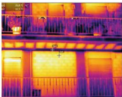
Facciata di edificio, \Delta T = 3.3 \text{ }^\circ\text{C} giugno, esposizione sud, ora di pranzo
