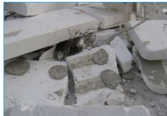
Assenza di incollaggio perimetrale
