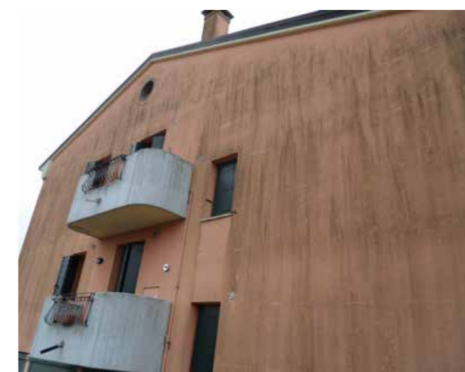
Attacchi di muffe e alghe su edifici isolati con sistemi a cappotto
