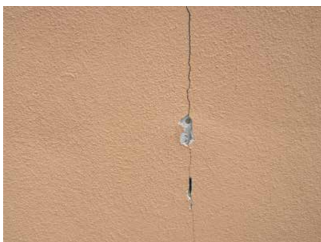
Fessurazioni in corrispondenza di fori finestra e di giunzione pannelli isolanti
