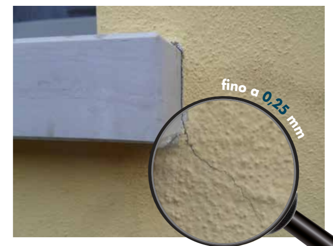
Cavillature in corrispondenza di spigoli e fori finestra
